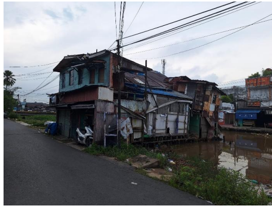
Gambar 2. Kondisi eksisting degradasi struktural titian dan sanitasi lingkungan di Kelurahan Sungai Baru
